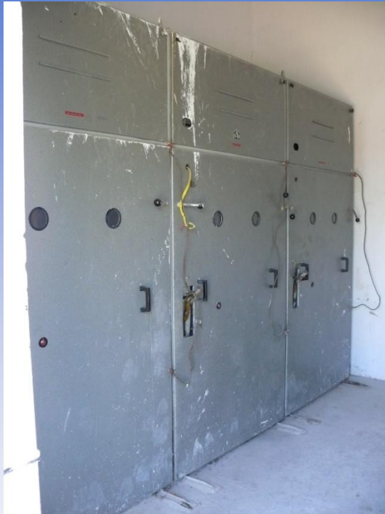
A 22 kV-os elavult kapcsolóberendezések cseréje a biztonságos üzem érdekében
