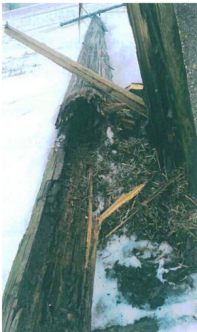
9. kép: Barcsisi őrház áramellátó hálózat megrongálódása
