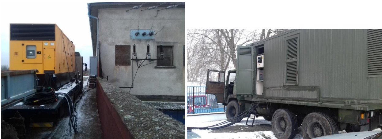
7-8. kép: nagyteljesítményű aggregátorok a Villogói és a Mirhói szivattyútelepeken
