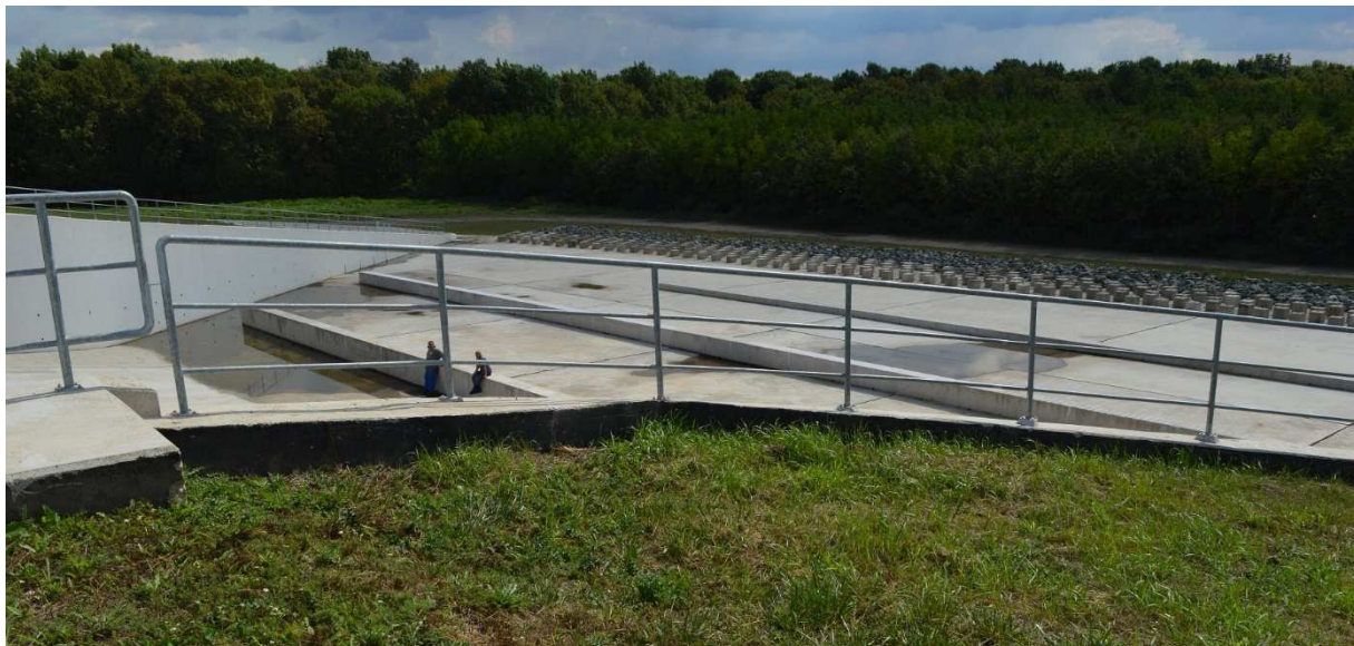
6. kép. Alsó vízbeeresztő műtárgy utófenekén megálló víz és a szárnyfal háttöltés süllyedése
