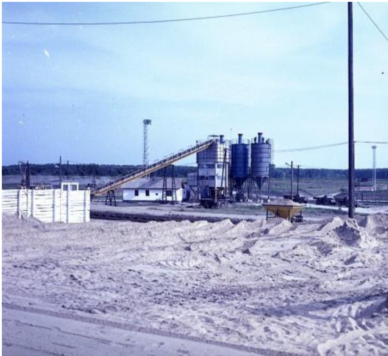
Automatikus üzemű betongyár (30 m 3 /óra)
